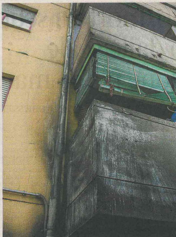
Incendio Il rogo che il 14 febbraio ha danneggiato gli alloggi di via Bolla
