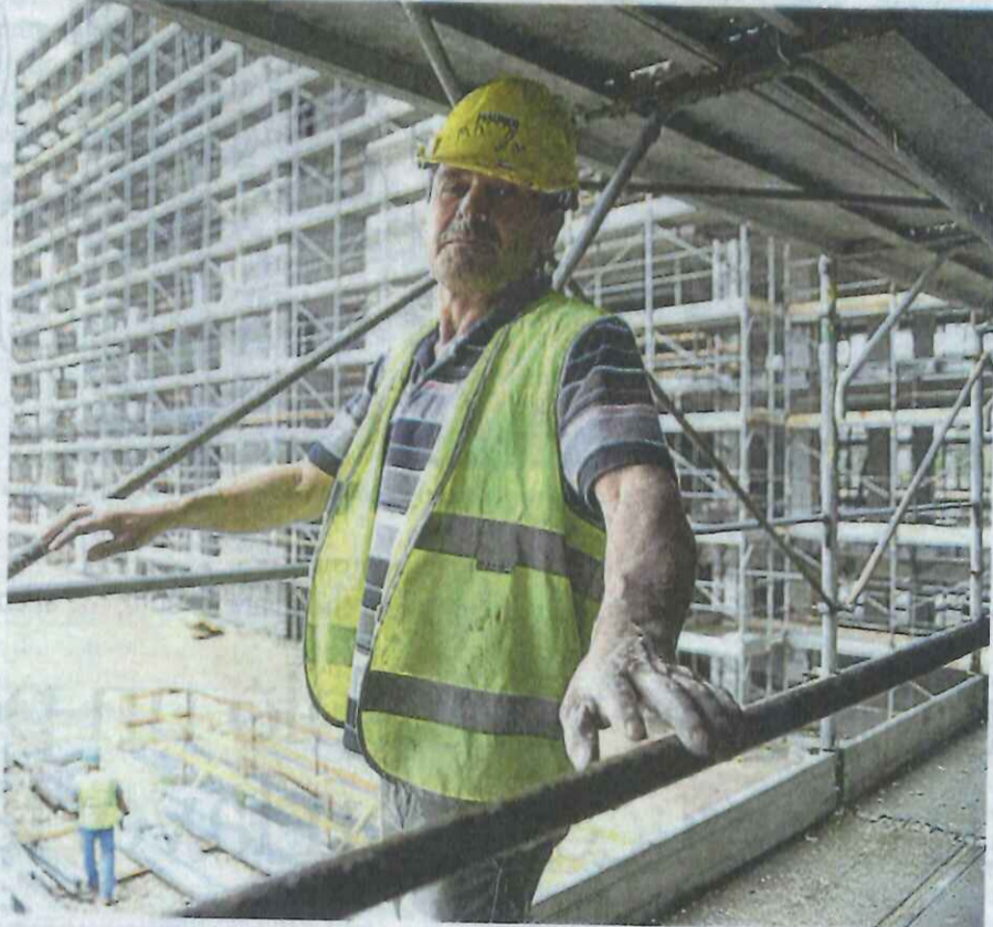
LAVORI Il cantiere per la costruzione del nuovo studentato universitario. La struttura sorge sulle basi del vecchio Palaspecchi (foto archivio Businesspress)
