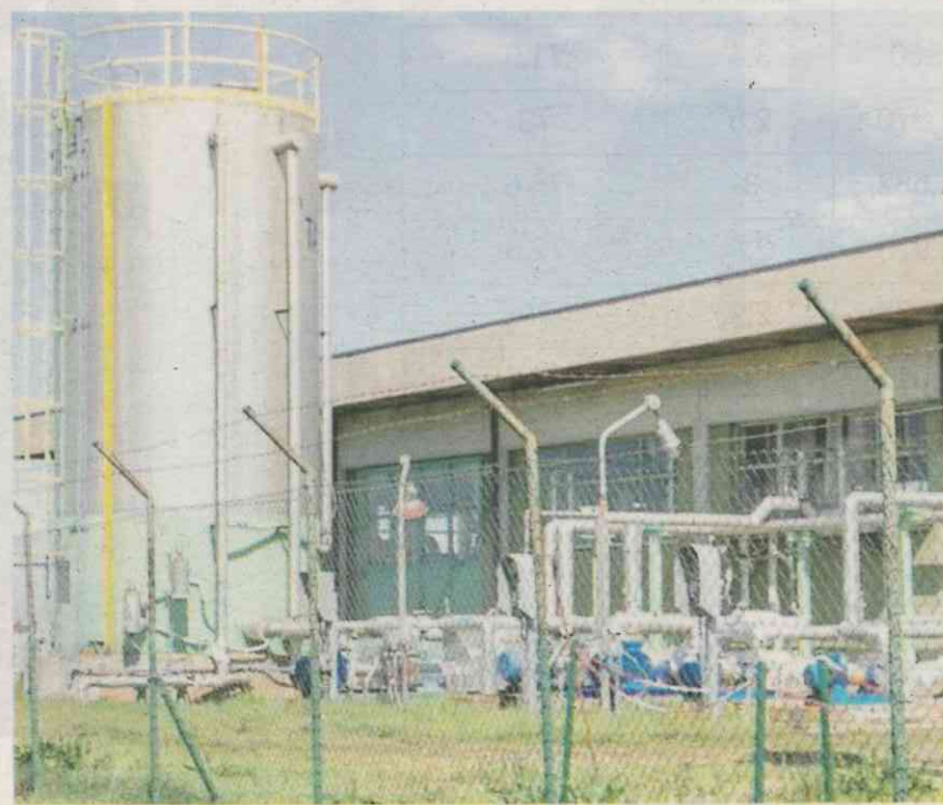
L'impianto di geotermia a Cassana
